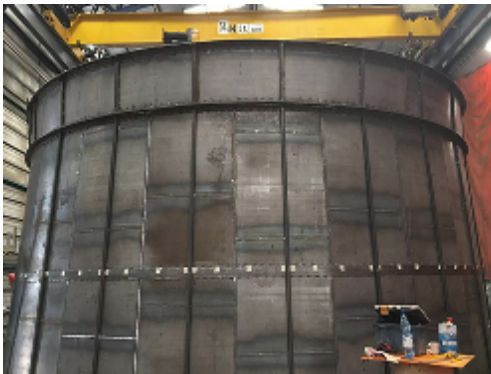
Estanques y Equipos de Proceso
